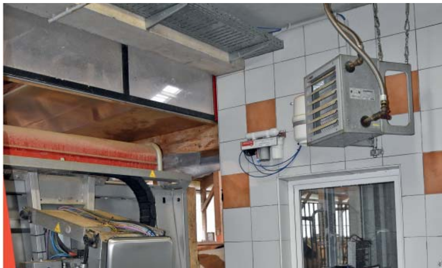
Bild 6: Ein Heizlüfter hält die Melkbox frostfrei.
