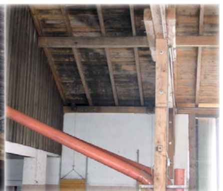
Bauschäden durch Kondensat am Dach.
